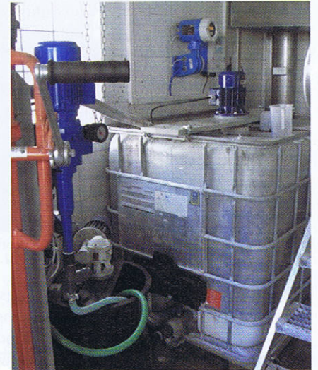
Abb. 5: Vorlagebehälter (hinten), Flockungsmittelbehälter schwarz (vorne)
