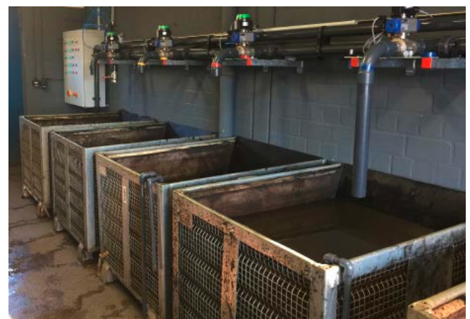
Bild 2: Einsatz der Entwässerungscontainer Draincon 900 zur Schlammmentwässerung an einer Mülldeponie
